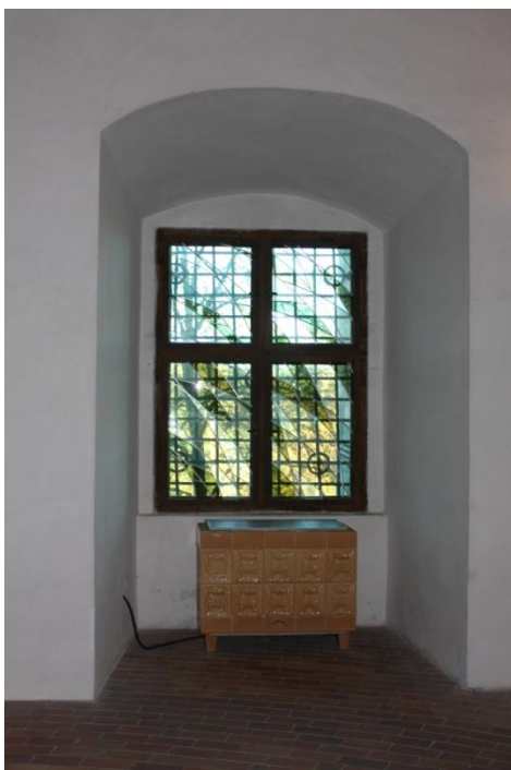
Obr. 15. Okno v západní stěně
