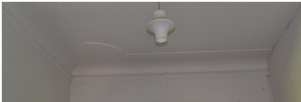
57 Přerušený stropní štukový rámeček novější příčkou.
