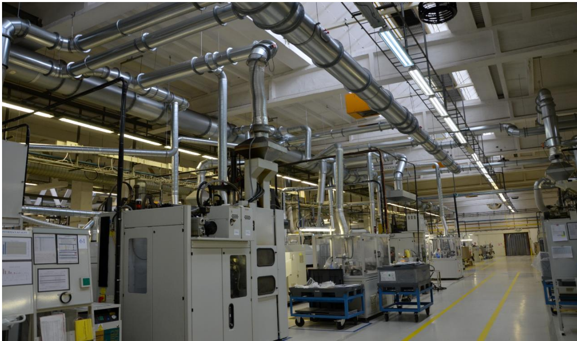
Obrázek 2: Výrobní a montážní hala společnosti
