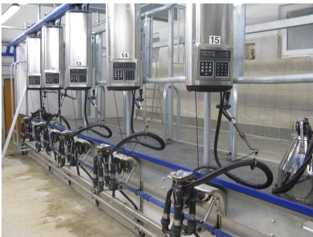
Obr. č. 6 – Dojící stroj nové dojírny (foto: A. Staňková, 2016)
