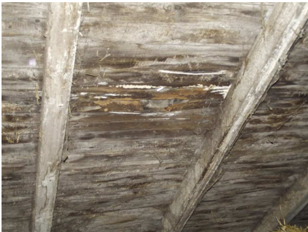
Příloha 8: Pohled H - Hniloba záklopu
