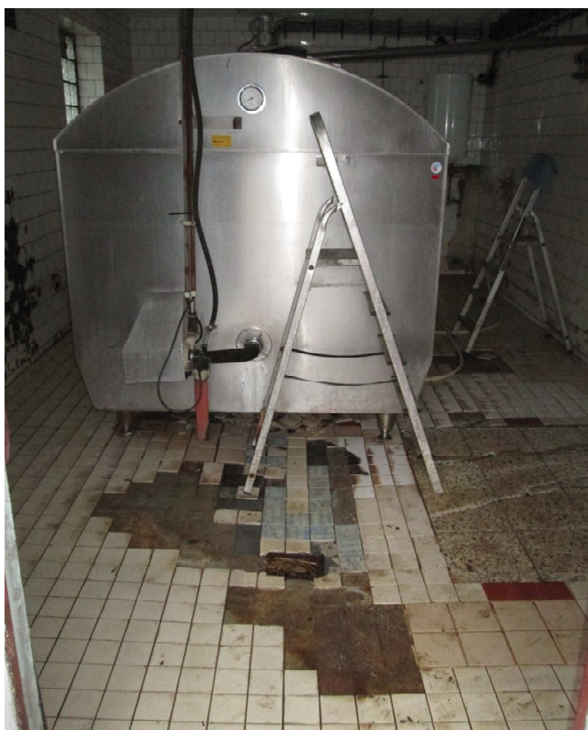
Příloha 12: Pohled L - Chybějící dlažba ve skladu
