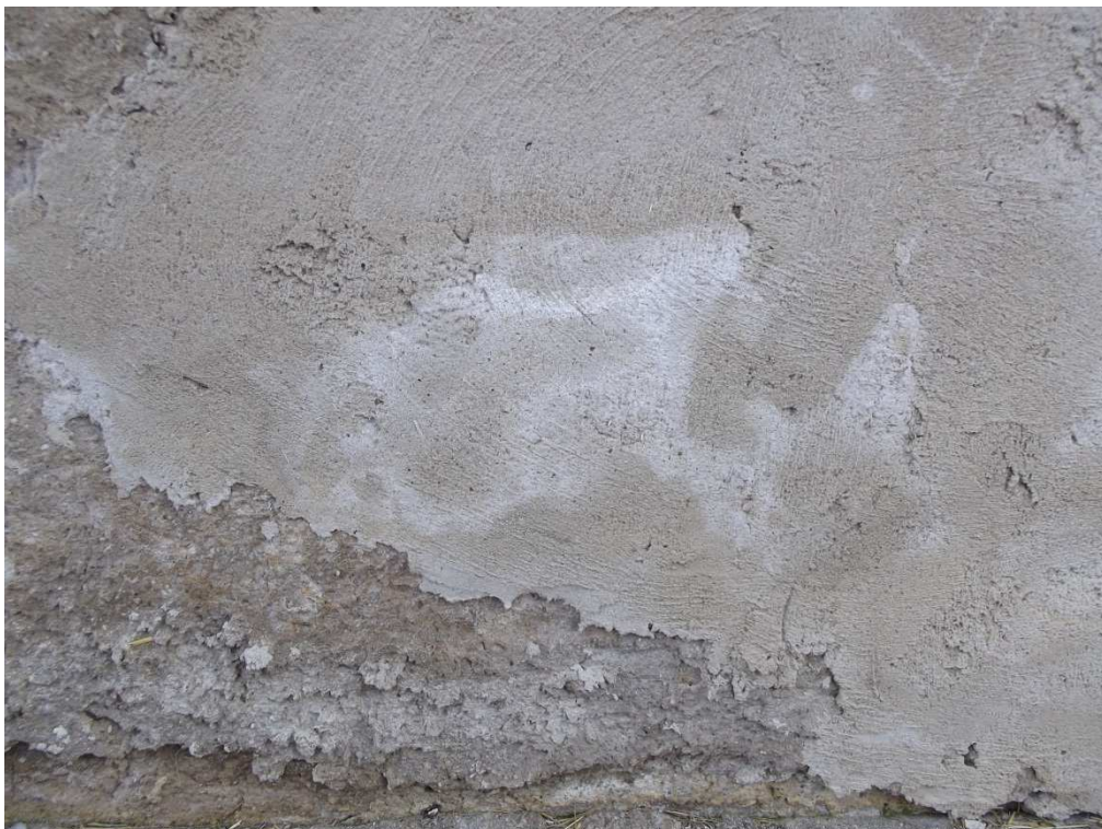
Příloha 7: Pohled G - Zasolené zdivo
