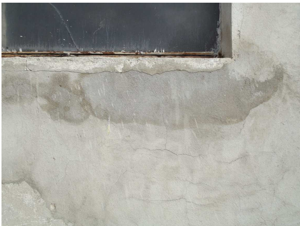
Příloha 6: Pohled F - Vlhké zdivo
