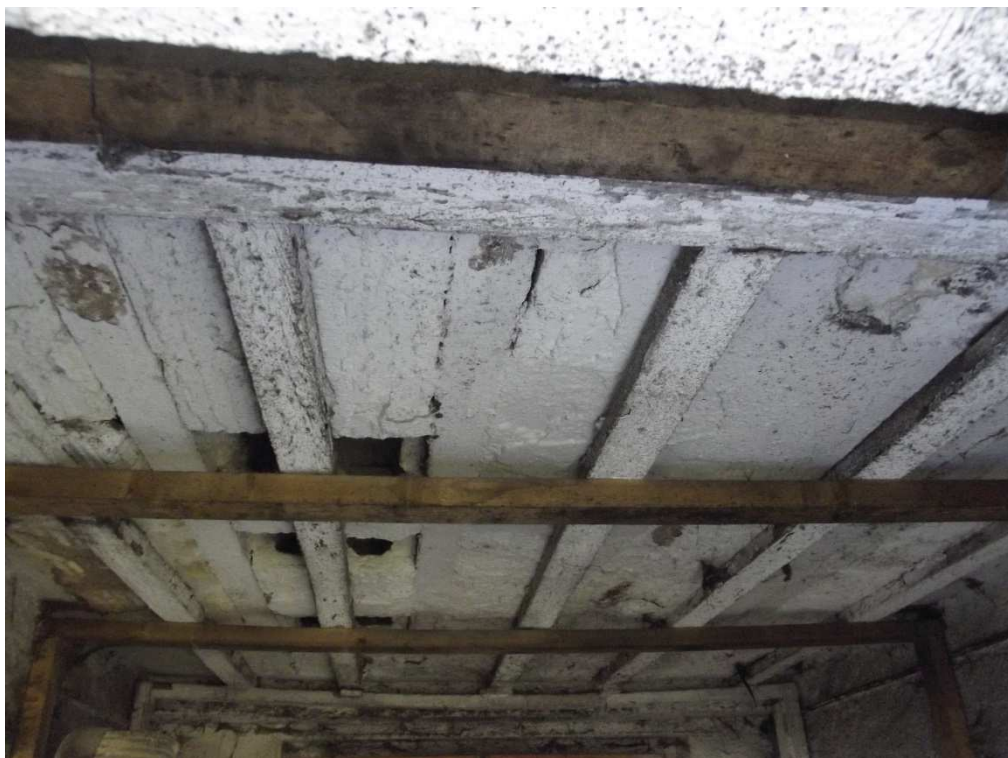
Příloha 9: Pohled I - Propadající se strop
