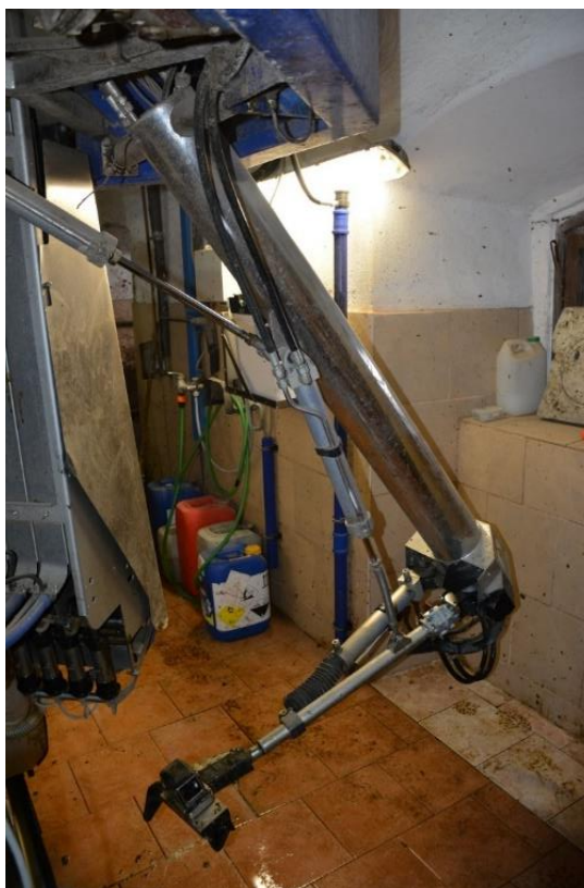
Obrázek č. 9 Víceúčelové rameno VMS
