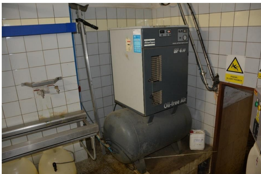
Obrázek č. 16 Bezolejový kompresor Atlas-Copco.
