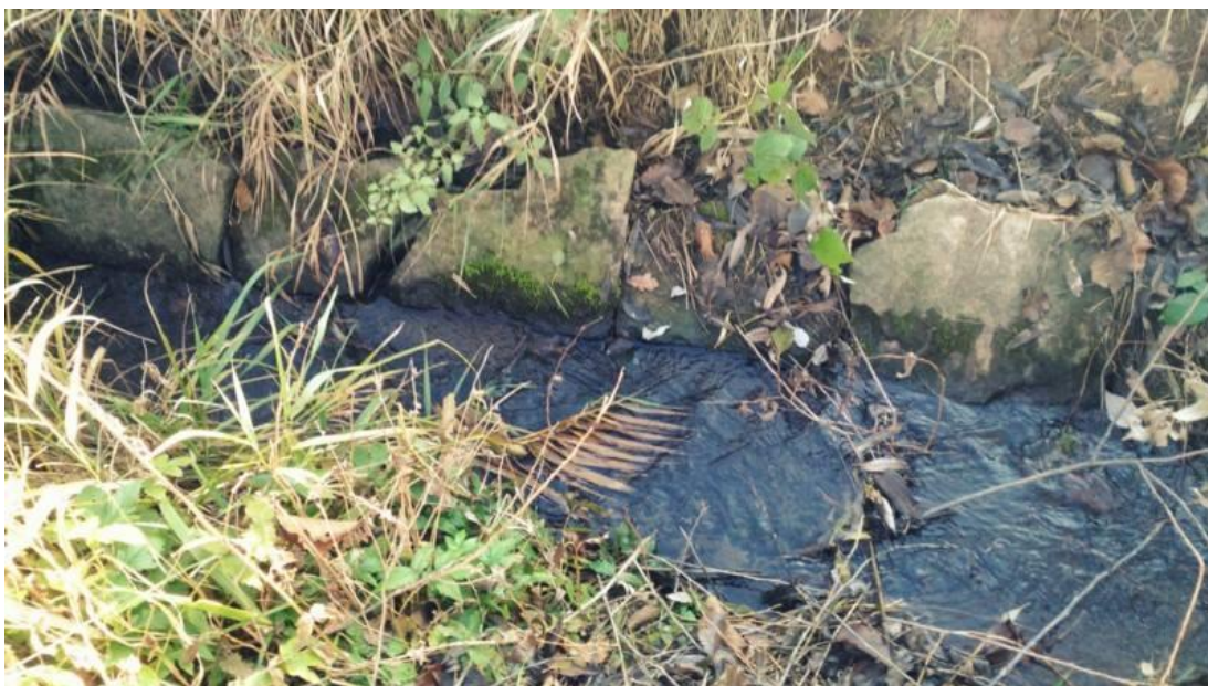
Příloha č. 1: Poškozené koryto toku
