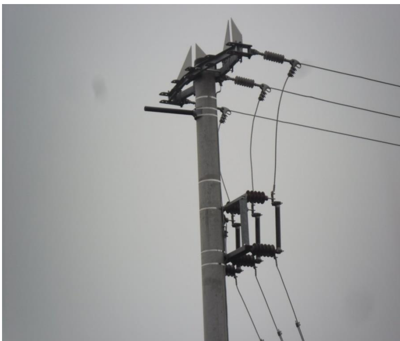
Obr. č. 8 Úprava již stávajícího rohového sloupu. Plastové chrániče brání dosedání ptáků na sloup ze shora. Je nainstalováno dosedací bidlo v krátkém provedení, umožňující bezpečné dosedání ptáků. Foto – autor.
