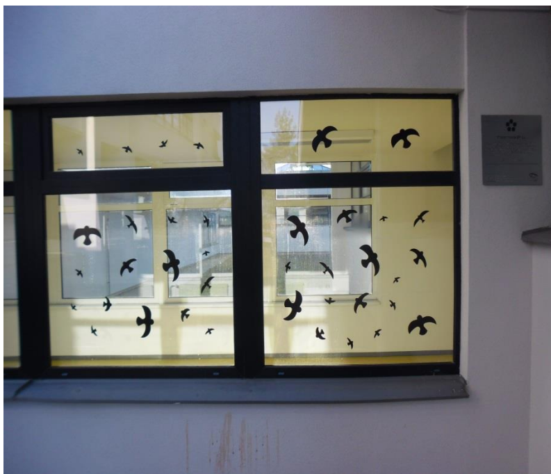
Obr. č. 15 Správné a účinné provedení polepu prosklené plochy, proti úrazům ptáků. Foto – autor.
