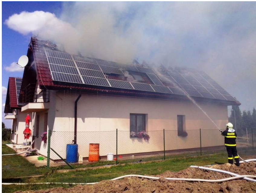
Obr. 34: Požár střechy Tlustovousy. Zdroj: Požáry.cz, 2014
