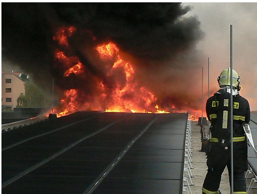
Obr. 36: Požár trubicových FV panelů. Zdroj: Požáry.cz, 2012
