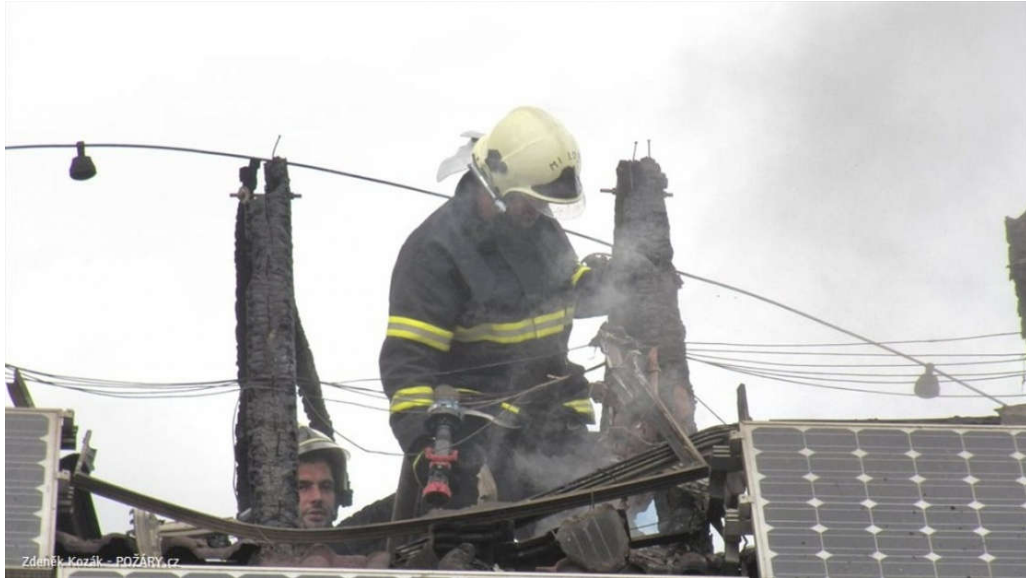
Obr. 35: Dohašování střešní konstrukce. Zdroj: Požáry.cz, 2014
