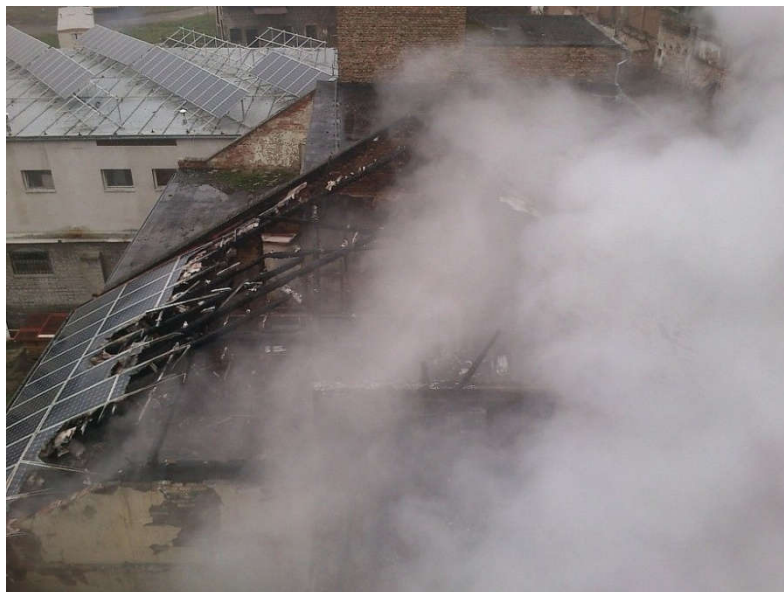
Obr. 31: Střecha s FV panely zasažená požárem. Zdroj: Jírový et al., 2016
