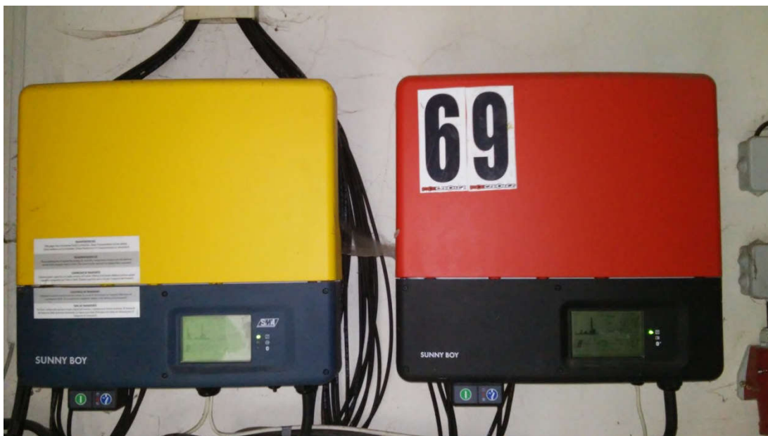
Obr. 22 Střídače FVE. Zdroj: autor
