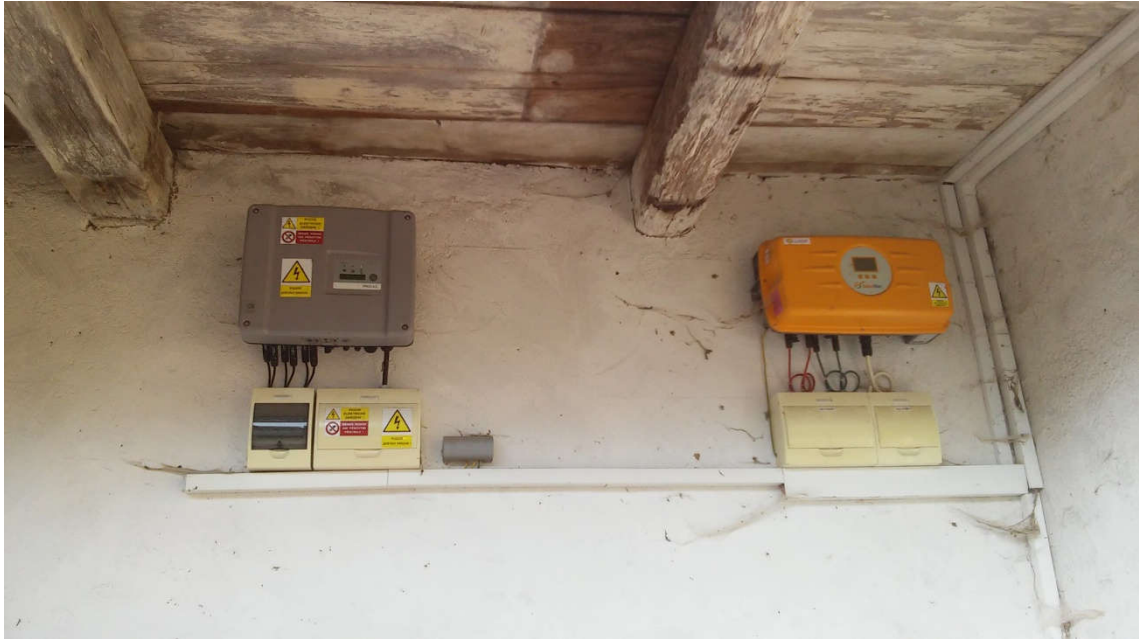
Obr. 19: Technologické vybavení FVE. Zdroj: autor
