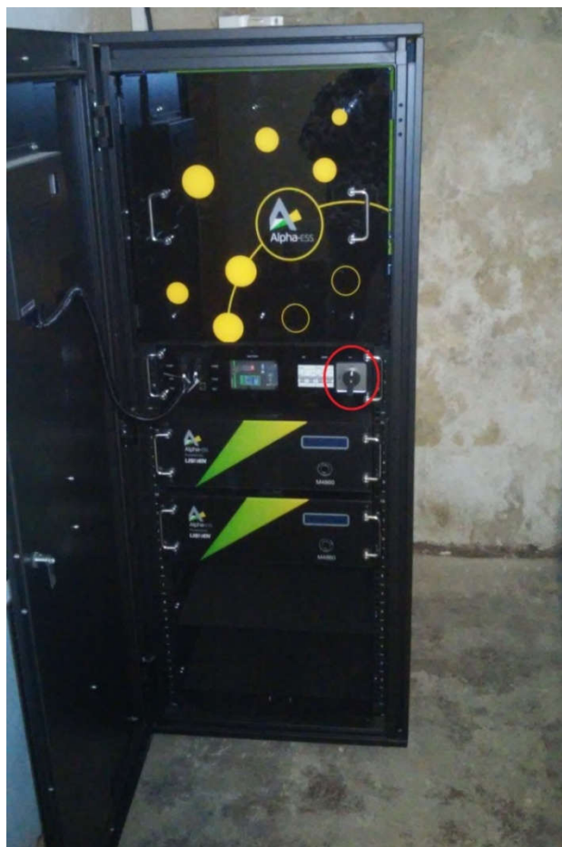
Obr. 17: Rack se střídačem a bateriemi, hlavní vypínač DC přívodu do střídače označen červeně. Zdroj: autor
