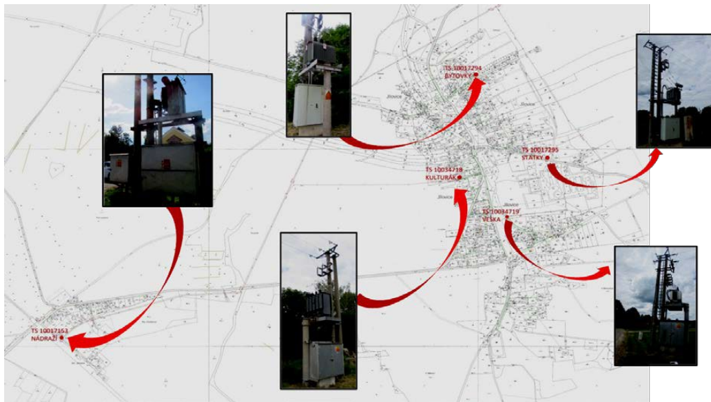
Obrázek 13: Distribuční trafostanice v Jílovicích, vlastní tvorba
