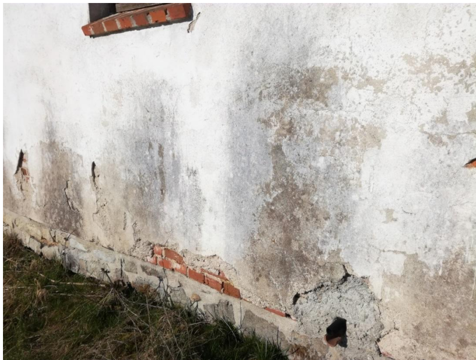
Obrázek 12: Projevy zvýšené vlhkosti
