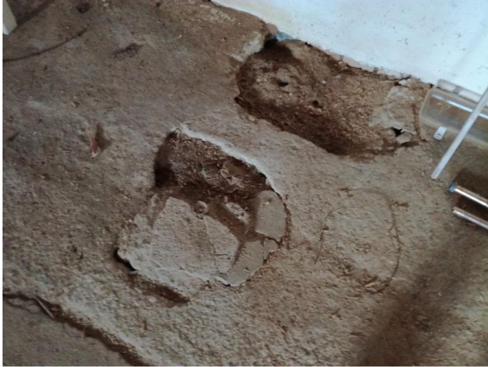
Obrázek 13: Poruchy v podlaze
