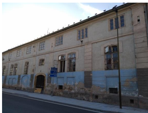
Foto autora č. 23 Budova panského pivovaru v zchátralém stavu
