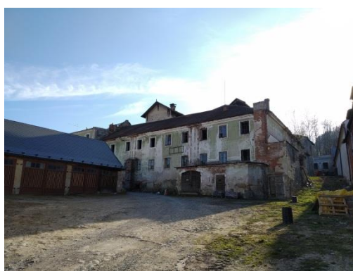
Foto autora č. 31 Dezolátní stav budovy pivovaru, která se snad brzy dočká rekonstrukce
