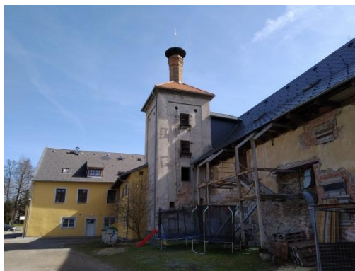
Foto autora č. 21 Zchátralé budovy panského pivovaru Pro Kaplici typické zachování komínů
