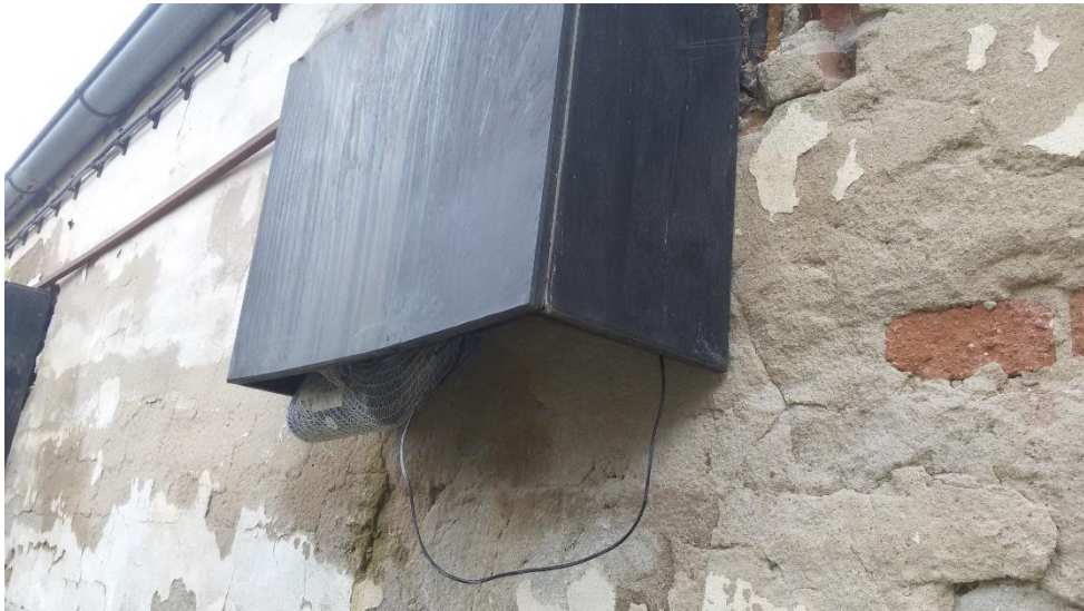
Obrázek 18 - Umístění Měřicího přístroje DUSTTRAK II v přívodní větrací klapce, zdroj: autor
