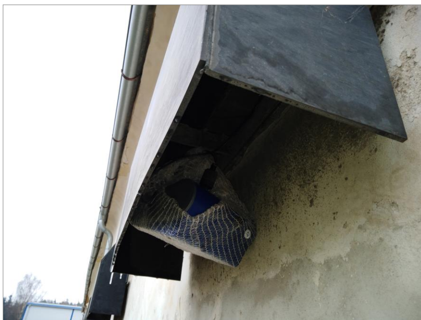
Obrázek 14 - Umístění Měřicího přístroje DUSTTRAK II v přívodní větrací klapce, zdroj: autor
