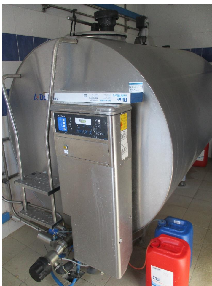
Obrázek č. 17 - Chladicí tank
