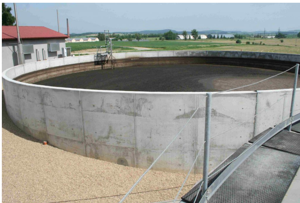
Obrázek č. 5 Tekutý digestát skladován v nádrži na fermentační zbytky
