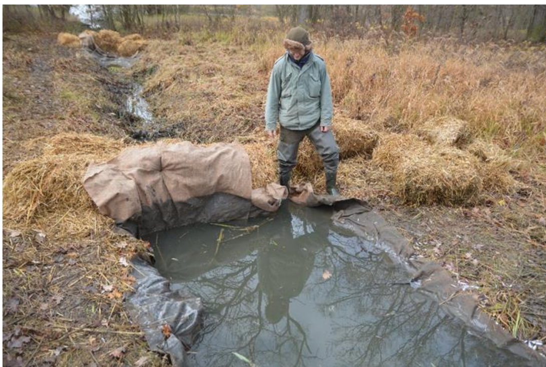
Obrázek 15 Detail první bariéry vystlané jutovou tkaninou proti podtékání bariéry (foto: Ján Regenda).
