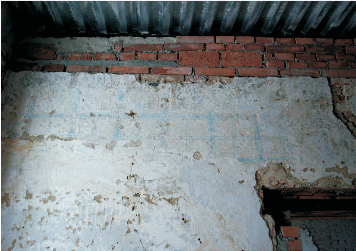
Obr. 21. Fragmenty interiéroových omítek doporučené ke konzervaci – stav 21. 9. 2018.
