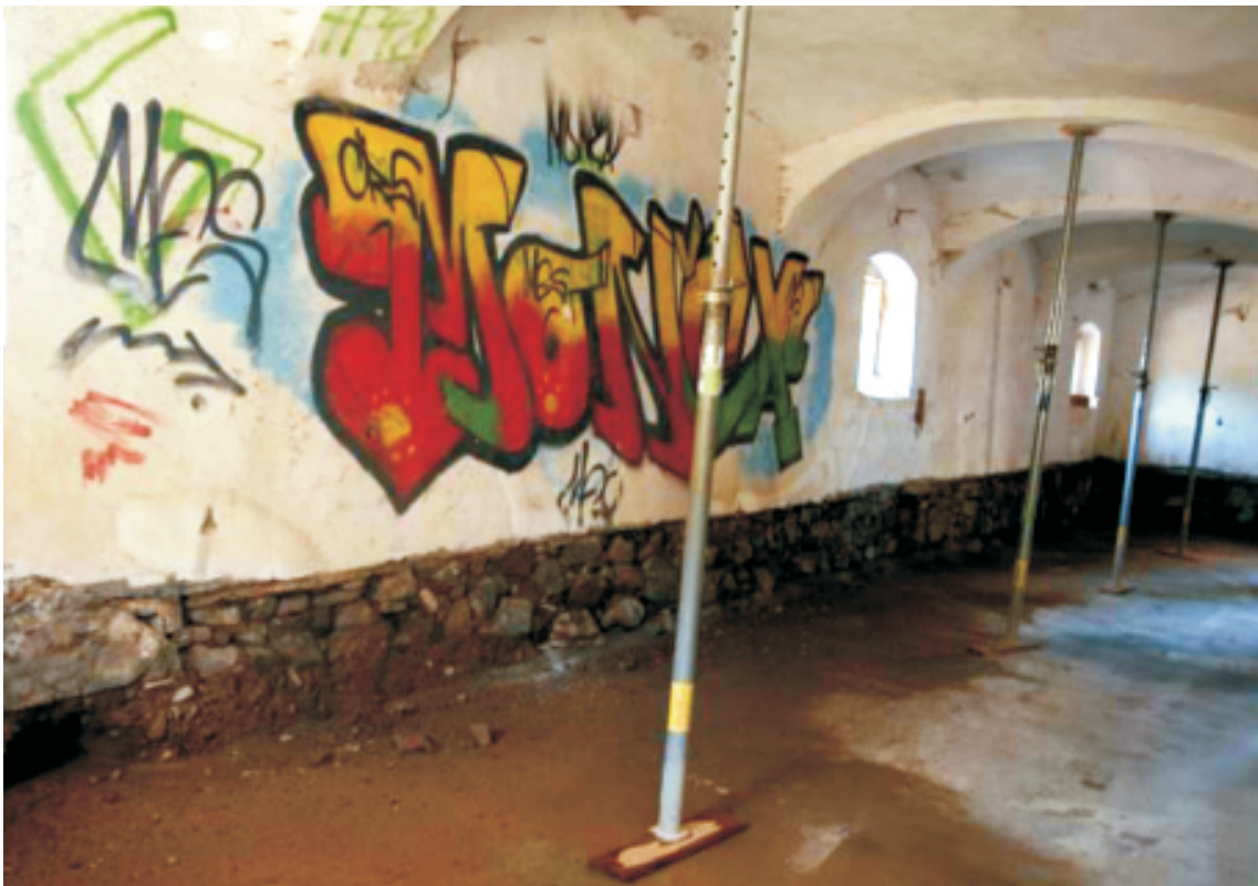
Obr. 20. Interiérové omítky znečištěné grafitti, doporučené k sejmutí.
