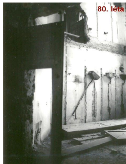
Obr. 113 Bývalé sociální zařízení na zámku s propadlým stropem v 80. letech 20. století. Zdroj: Zamek-cesky-rudolec.cz.
