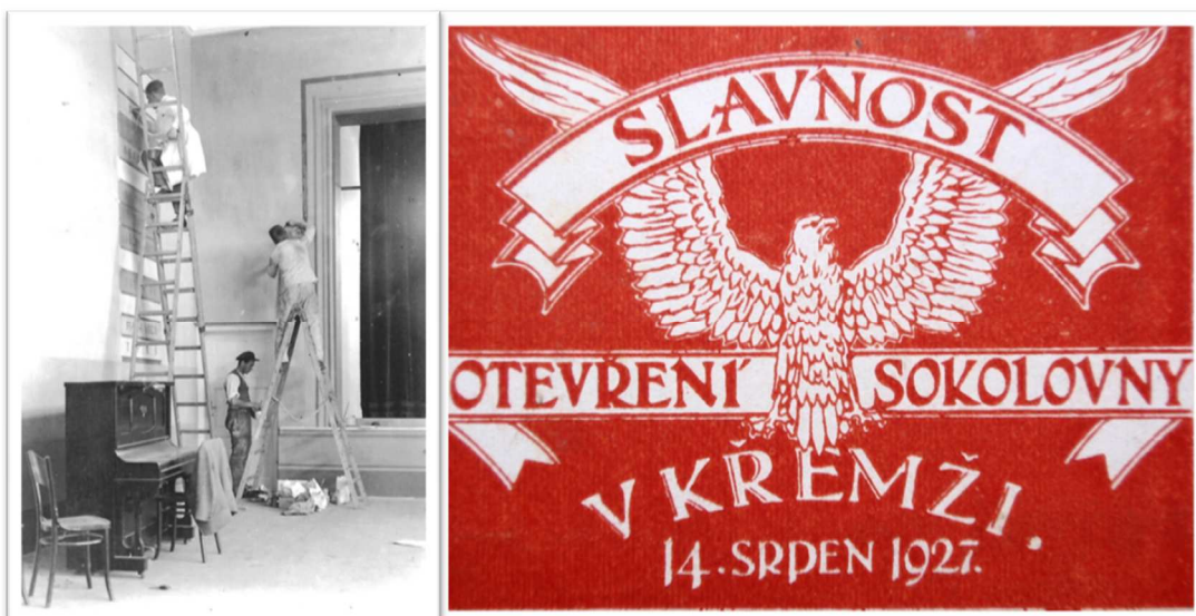
Obrázek 13. Na fotografii vlevo jsou zachyceny dokončovací práce na stavbě křemežské sokolovny v roce 1927. Vpravo je plakát vydaný ke slavnostem pořádaným k otevření sokolovny ve Křemži dne 14. srpna 1927. Kronika TJ Sokol Křemže.
