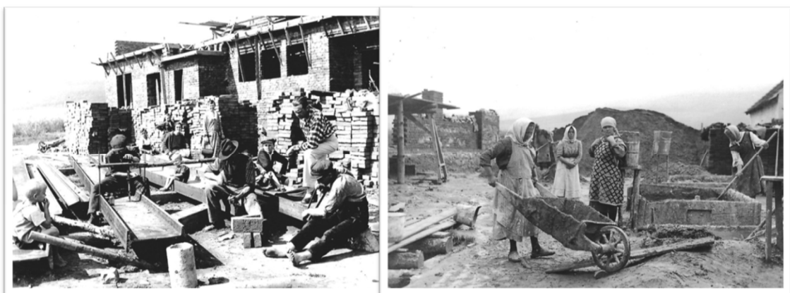
Obrázek 9. Na fotografiích z roku 1926 jsou zdokumentovány práce při výstavbě křemežské sokolovny. Vlevo připravují dělníci železné traverzy k osazení, vpravo jsou zachyceny ženy, které pomáhají připravovat stavební materiál. Kronika TJ Sokol Křemže.
