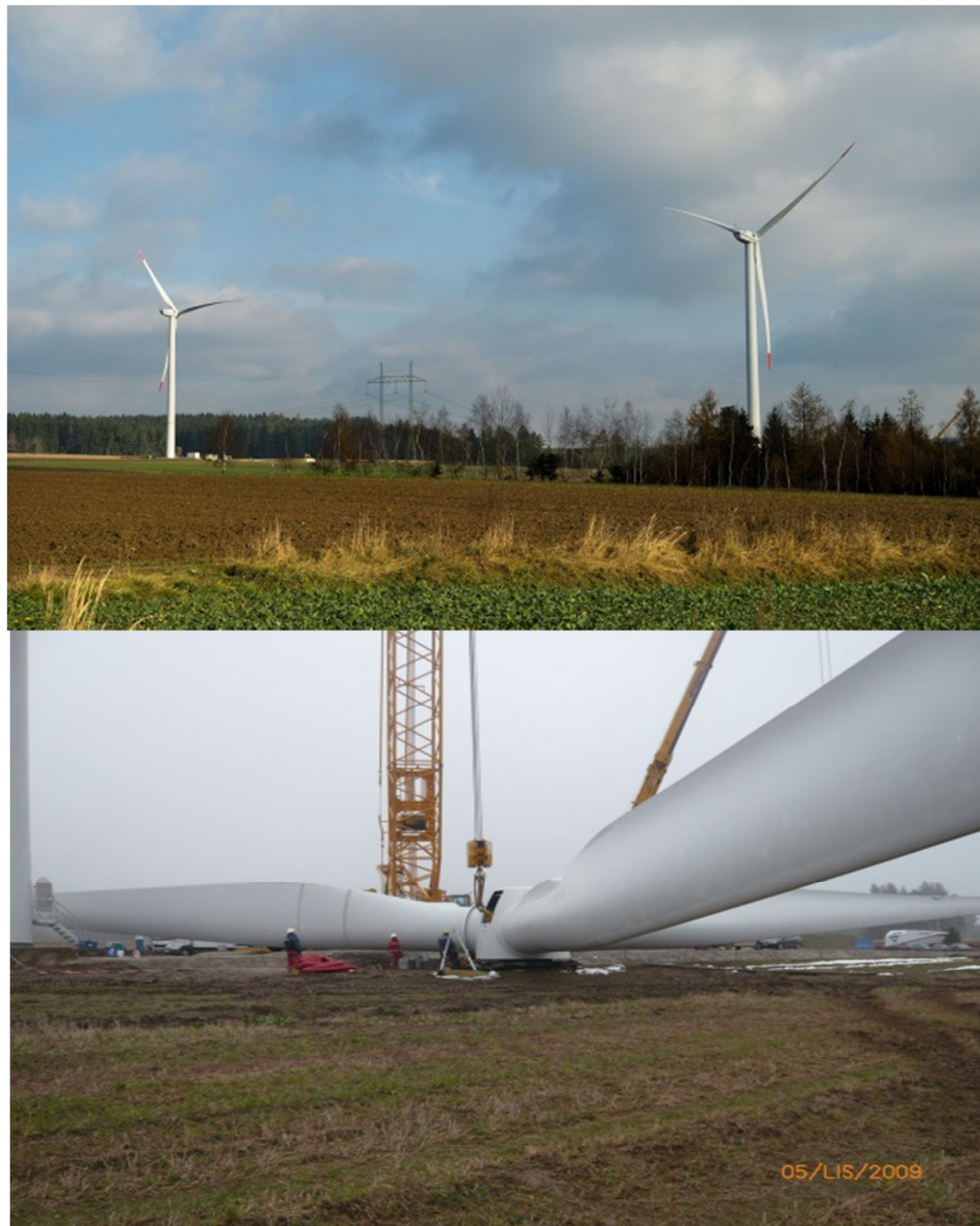
Obrázek č. 22 - Větrná elektrárna Janov a Věžnice – převzato z: [41]
