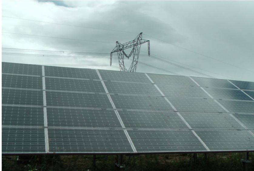
Obrázek č. 20 - Fotovoltaická elektrárna Ševětín – převzato z: [39]
