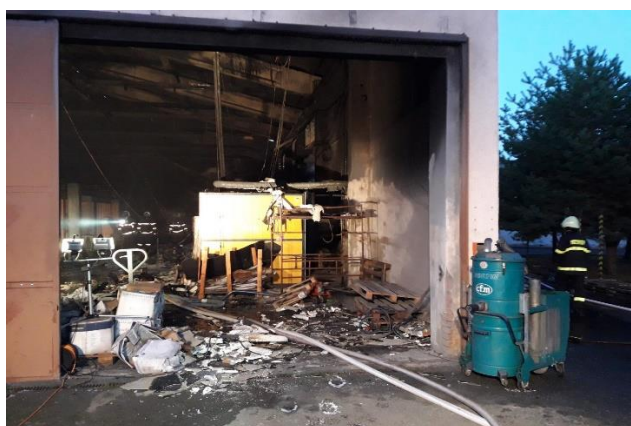
Obrázek 4 Shořelá hala lakovny Štěnovický Borek. Zdroj: https://www.hzscr.cz/clanek/pozar-haly-ve-stenovickem-borku.aspx
