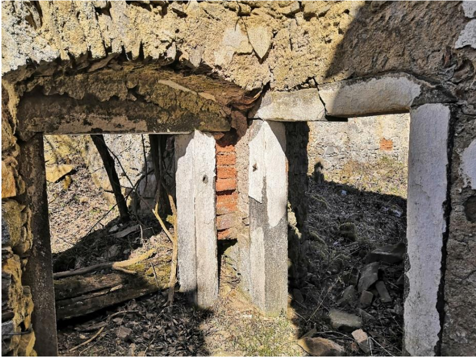
Obrázek č. 32: Horní části zárubní uvnitř domů (zdroj: vlastní)
