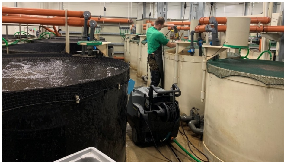
Obr. č. 15: Odstranění nečistot a silných nárostů z nádrže pomocí silného tlaku vody.
