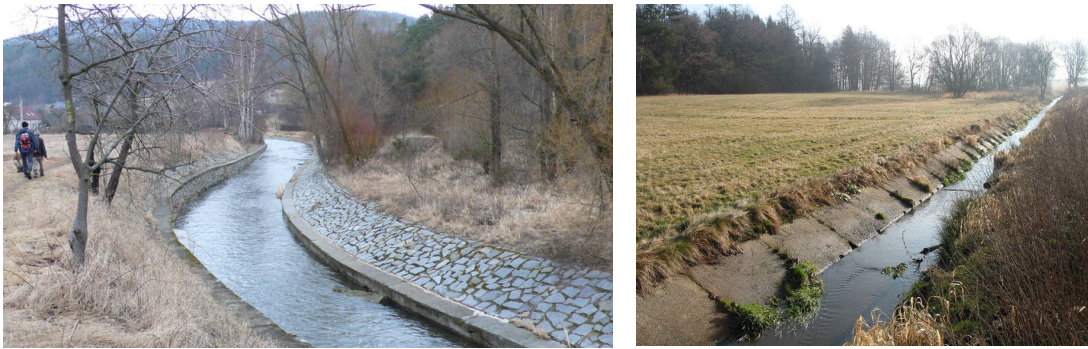
Obr. 11 a 12 – člověkem upravené koryto vodního toku s negativními následky pro ryby a ostatní vodní živočichy. Zdroj: www.strednicechy.ochranaprirody.cz
