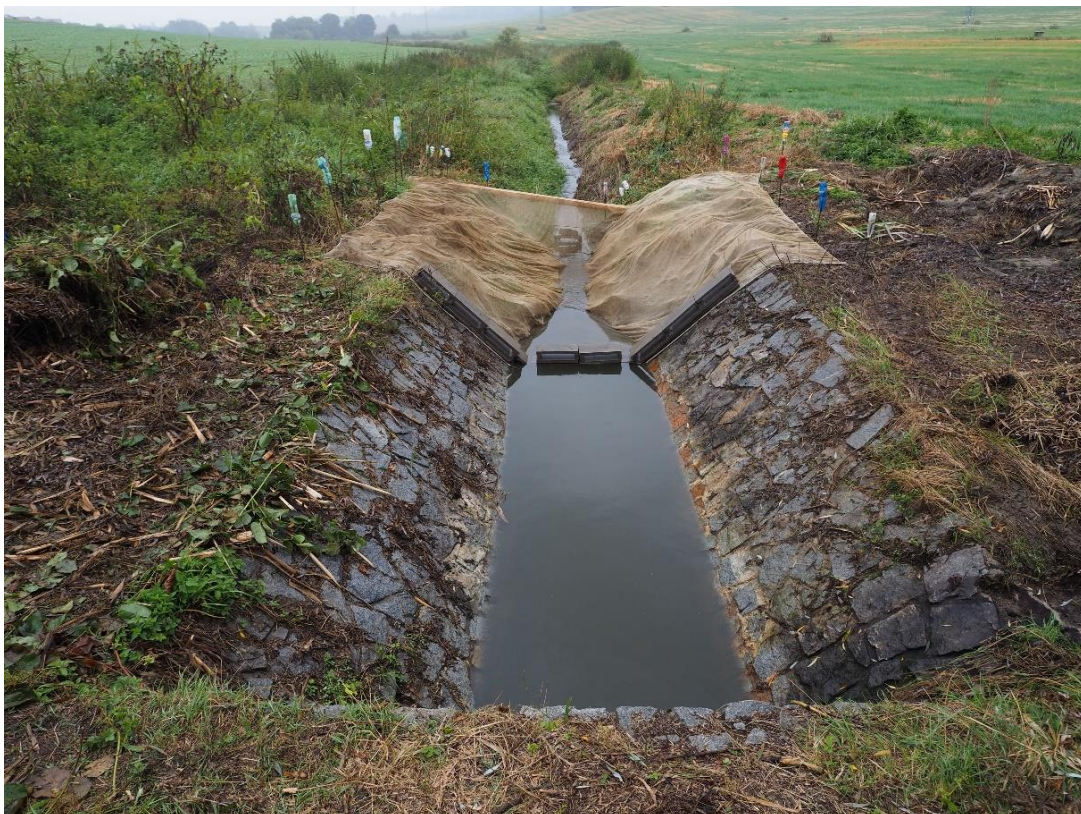
Obr. č. 9: Nainstalovaná podložní síť v odpadní stoce rybníka, sloužící k lovu unikající střevličky východní (foto Bořek Drozd)
