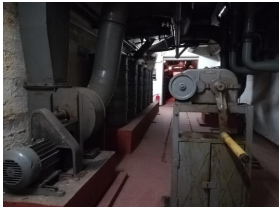
Obrázek 7 - Filtrační a ventilační zařízení
