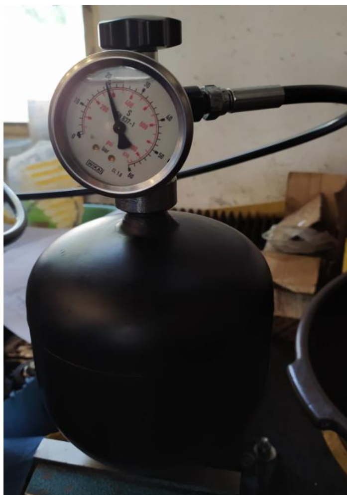
Obrázek 4.12 – Měření hydro-pneumatického akumulátoru
