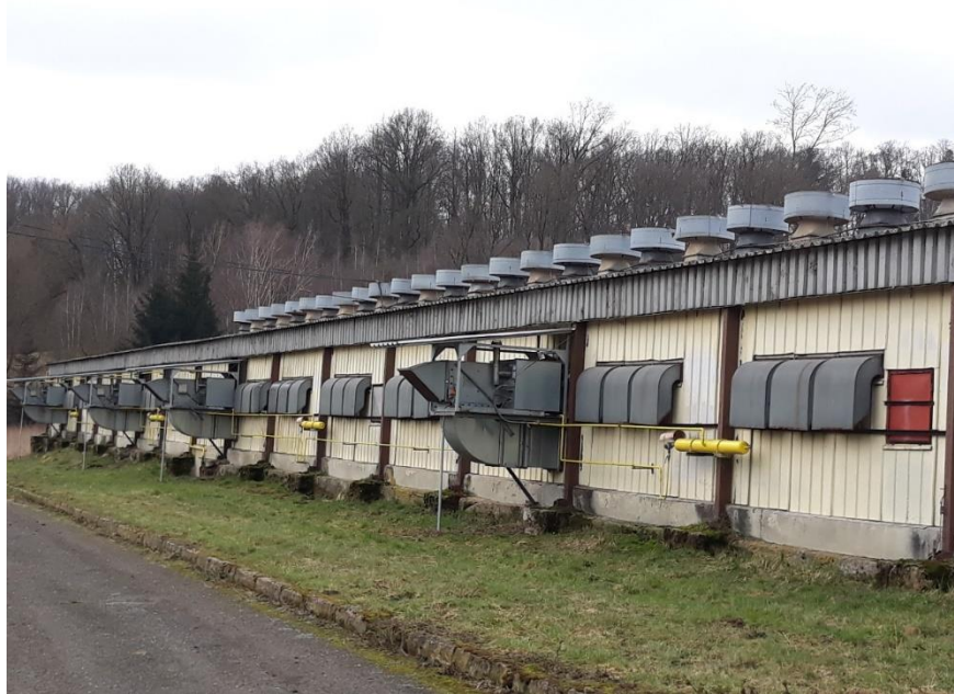
Ventilace zajišťující výměnu vzduchu v halách, řízená čidly.
