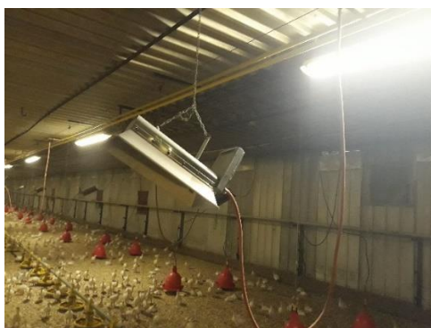
Infrazářiče zajišťují požadovanou teplotu v hale v prvních týdnech odchovu
