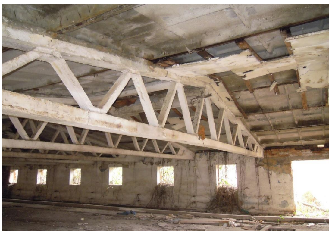
Obrázek 4.12 – Příhradové vazníky na nichž leží panely, zbytky dřevěného podhledu (vlastní)
