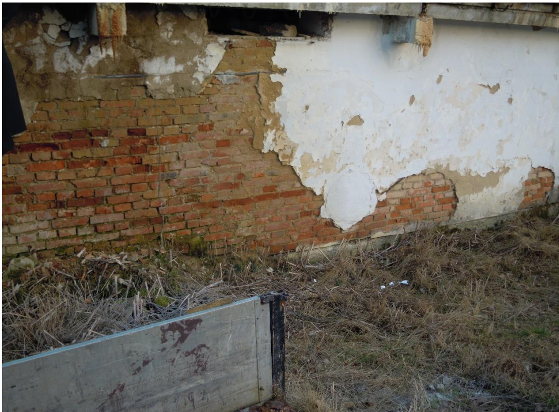
Obrázek 4.10 - Detail odpadávající omítky (zdroj: vlastní)
