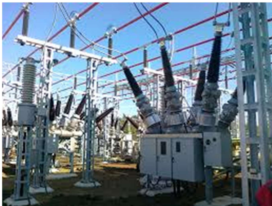
Obrázek 2.14: Rozvodna Dasný (vlastní)
