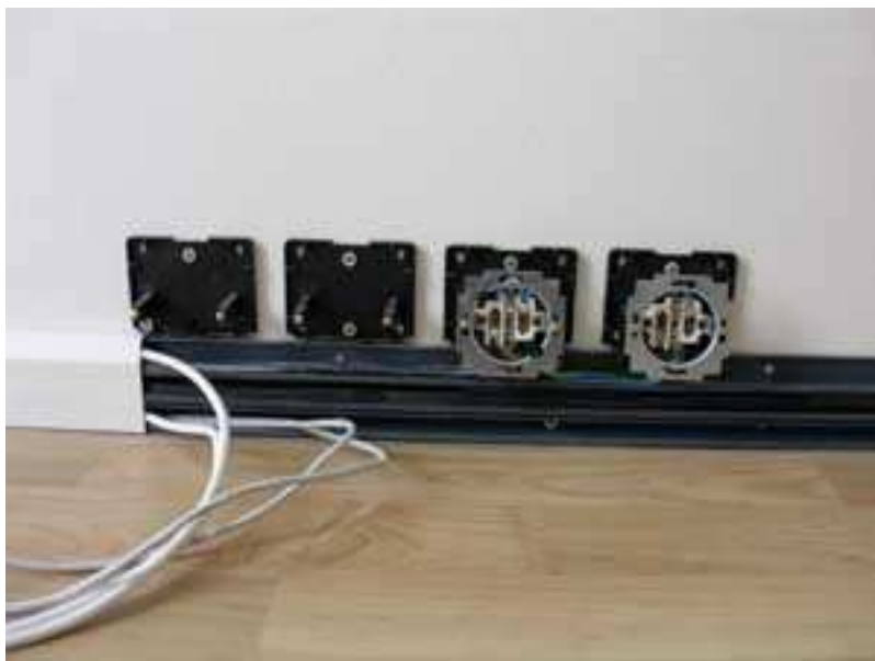
Obrázek 4 Příklad povrchového uložení částí elektroinstalace při podlaze
