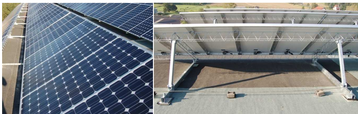
Obrázek 1: FVE instalovaná na střeše budovy
