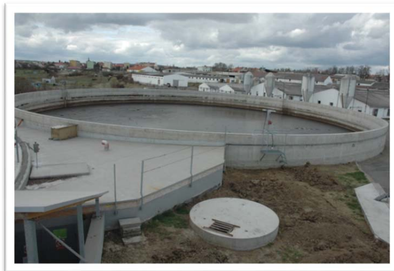
Foto 8 Jímka na digestát
