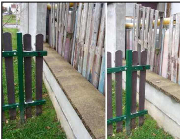
Obrázek 15: Poškozené oplocení u dětského hřiště v ulici Osiková - Fibicha
