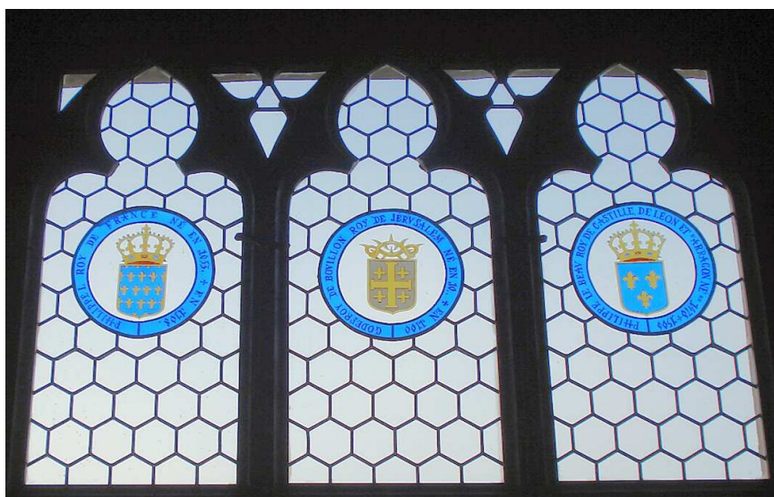
Obr. 32: Křížácká galerie v Rožmberku nad Vltavou: Současný stav vitrážového okna
