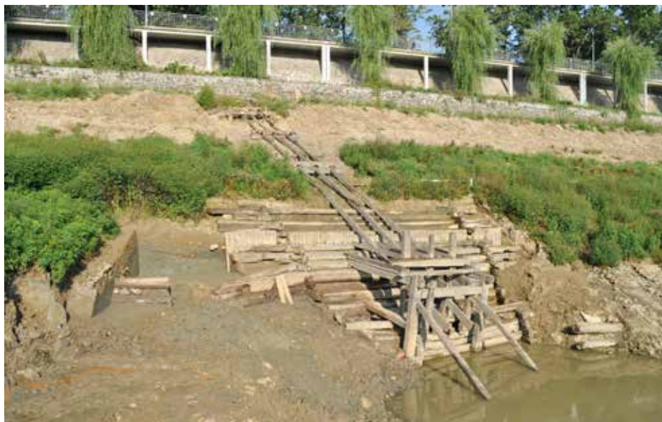
Obr. 9. Tábor – Jordán. Jižní spodní výpust – celkový pohled na dřevěné konstrukce se svahovými táhly a rámem pro časové ovládání výpustných rour včetně zpevnění návodní strany hráze kolem nich kompaktní schodovitou dřevěnou stěnou. Vpravo a vlevo od soustavy jsou patrné vodorovně položené kmeny, které zpevňovaly patu návodní strany hráze. Abb. 9. Tabor – Jordan-Stausee. Südlicher unterer Ablass – Gesamtansicht der Holzkonstruktion mit Zugstangen und dem Gestell für die Zapfenbedienung der Ablassrohre einschließlich der sie umgebenden Befestigung der Wasserseite des Dammes durch eine kompakte treppenartige Holzwand. Rechts und links des Systems sind die waagrecht ausgelegten Stämme zu sehen, die den Fuß der Wasserseite des Dammes befestigen.
