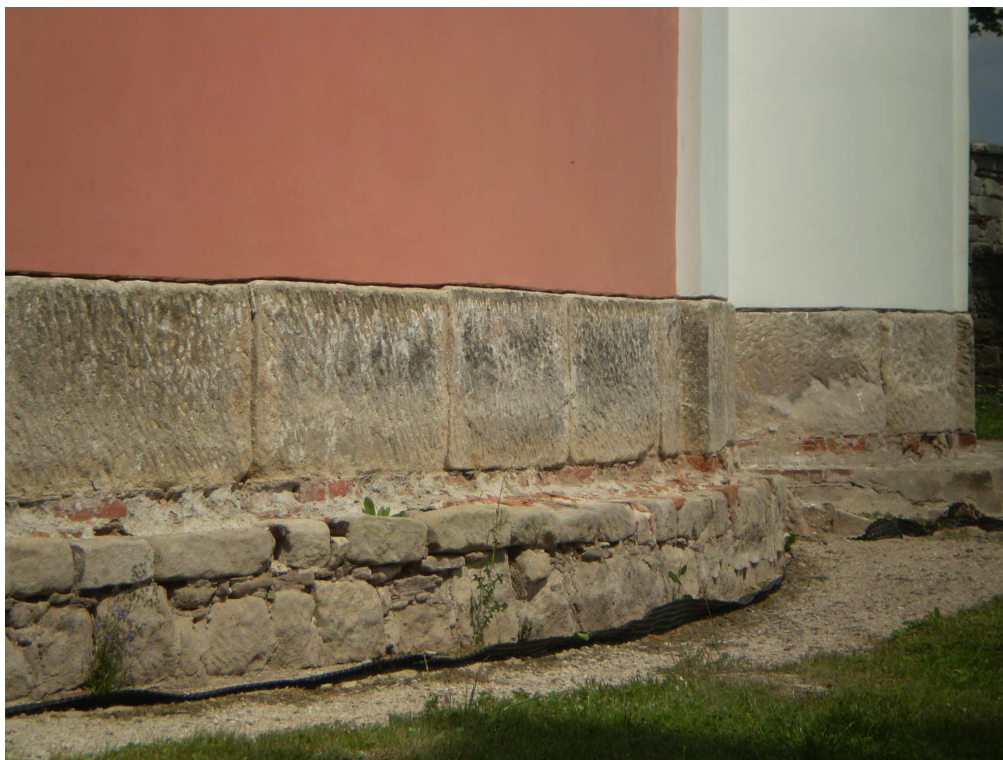
obr. č. 23 Detail trnože u božanovského kostela fotografie L. Švecová
