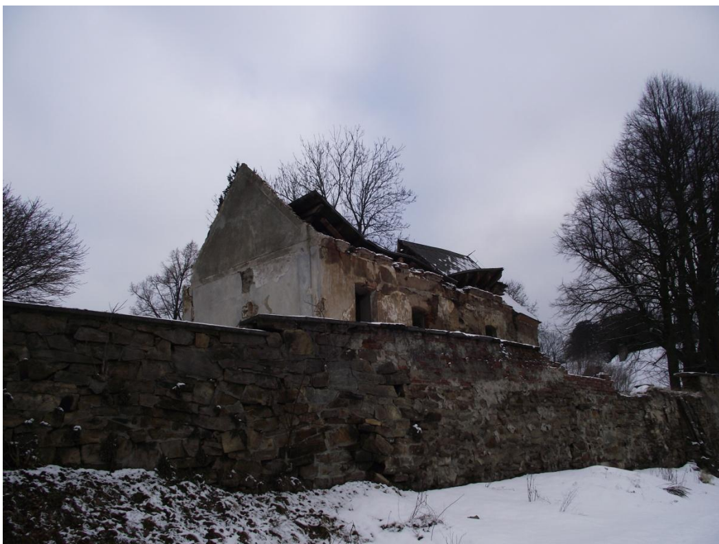
81/ Kostel sv. Jakuba v Loučovicích, pohled od hřbitovní zdi – stav po zřícení střechy lodi
