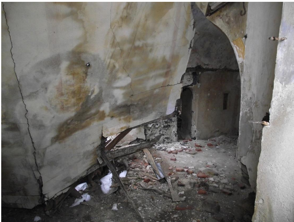
94/ Kostel sv. Jakuba v Loučkově, pohled do interiéru z okna jižní strany lodi – stav po zřícení stropu
