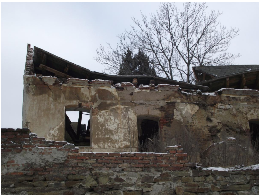
82/ Kostel sv. Jakuba v Loučově, zřícená střecha lodi
