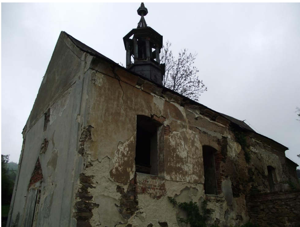
78/ Kostel sv. Jakuba v Louhově, stav lodi před zřícením střechy
