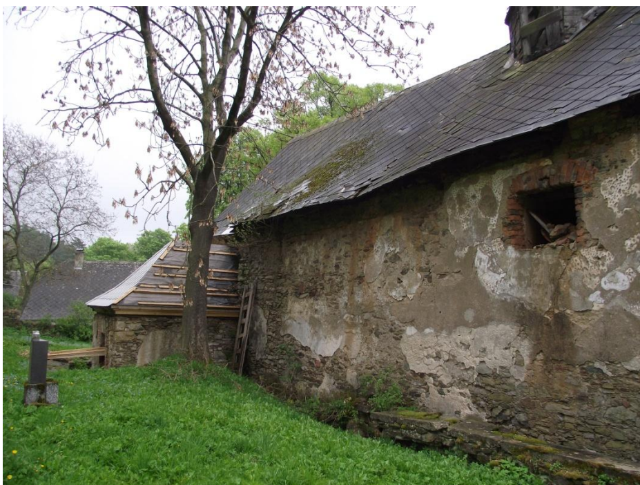
79/ Kostel sv. Jakuba v Louhově, stav lodi před zřícením střechy – severní strana lodi
