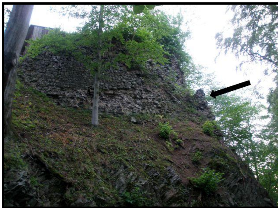
Foto 15. Kumburk – Polozapuštěná budova, opěrák zajišťující severní nároží, pohled z východu (foto autor).
