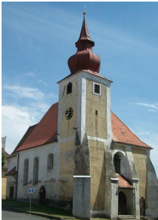
Obr. 10: Chrám Nanebevzetí Panny Marie ve „švamberském Ronšperku“ (dnešních Poběžovicích u Domažlic) od pohřbu Jana Jiřího proměnil svoji tvář nejen působením rekatolizace, ale rovněž zanedbaným stavem druhé věže, jež musela být v 19. století stržena.
