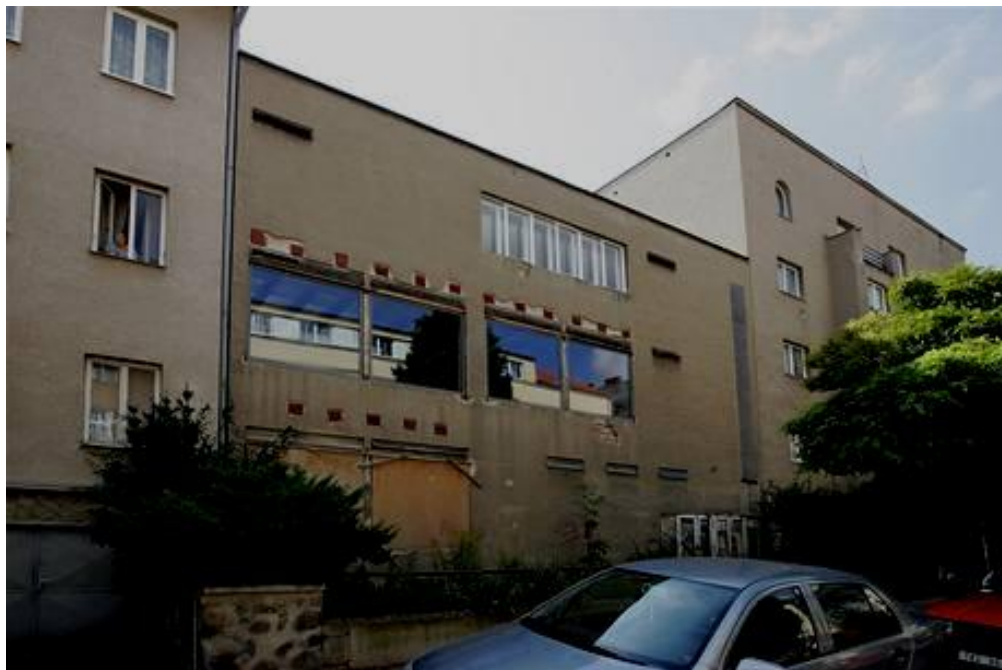
Obr. 11. Chátrající kavárna ERA
