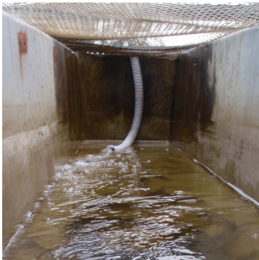
Obrázek 8-3. Upravený přítok do žlabu s nízkou hladinou.
