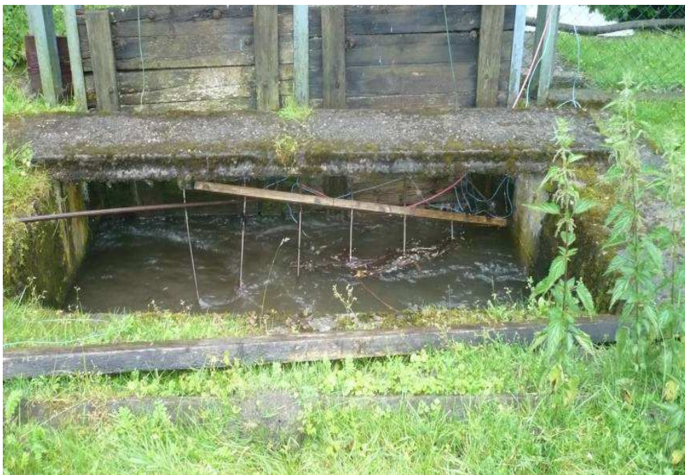
Obrázek 7-5. Zařízení umístěné v přítokovém náhonu.
