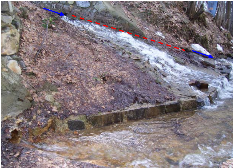
Foto č. 4: Poškozený bezpečnostní přeliv. Graficky je znázorněno podemílání tělesa hráze.
