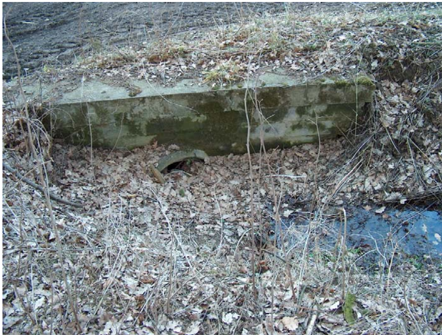
Obr. č. 5 Opad stromů způsobující nefunkčnost propustku a tím i možné rozlití vody do přilehlé skládky, kde se odtékající voda kontaminuje.
