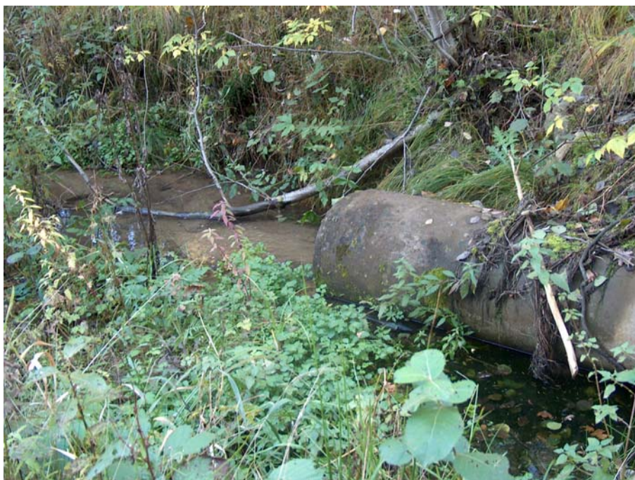
Obr. č. 13 Technicky nevhodně umístěný propustek.
