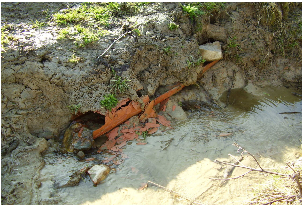
Obr. 6: Odkrytá část drenáže vodní erozí, Jenín 1.
