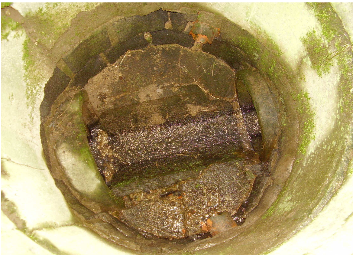
Obr. 10: Funkční drenáž na mikropovodí Jenín 2., šachtice č.3
