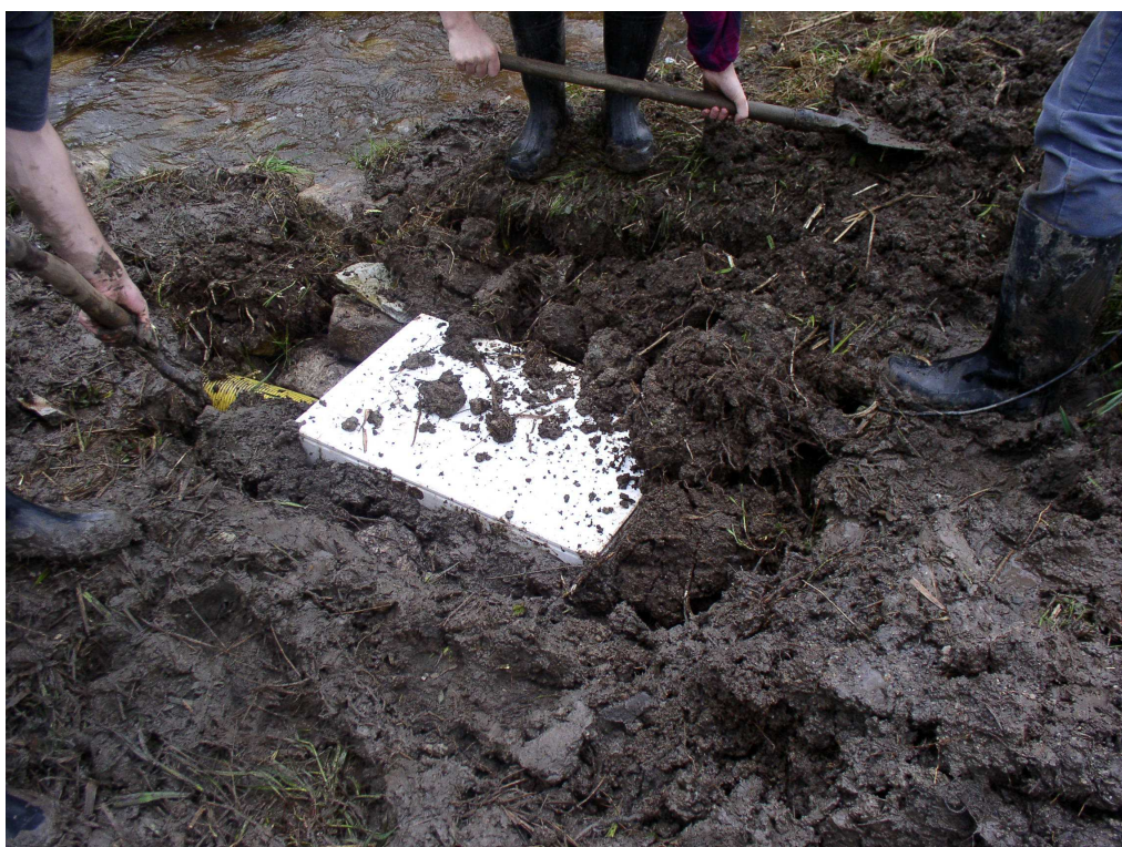
Obr.3: Měrný box po instalaci
