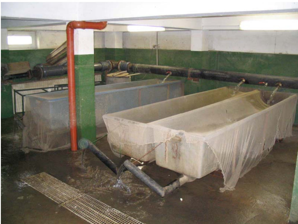
Obr. C2: Průtočné laminátové žlaby.
