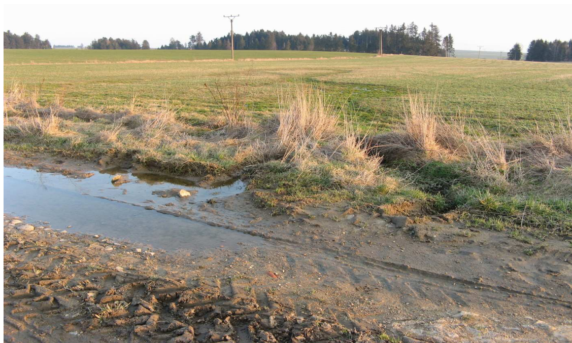
Obrázek č. 5: Hlavní cesta C7 – odtékající voda z komunikace do ZU 5
