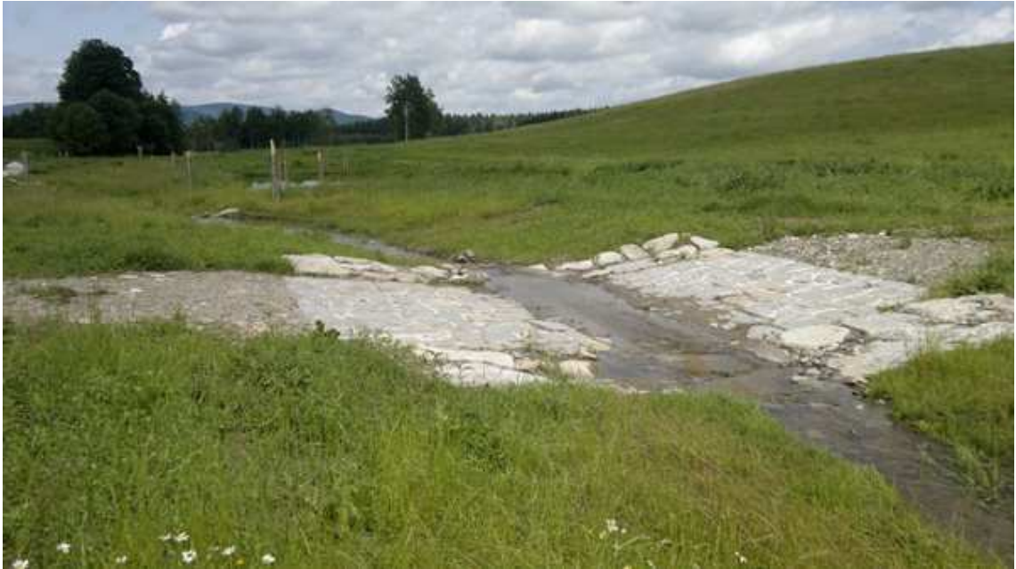
Obr. č. 27. Všeměřický potok, úsek nad Horním všeměřickým rybníkem, dokončená stavba brodu.
